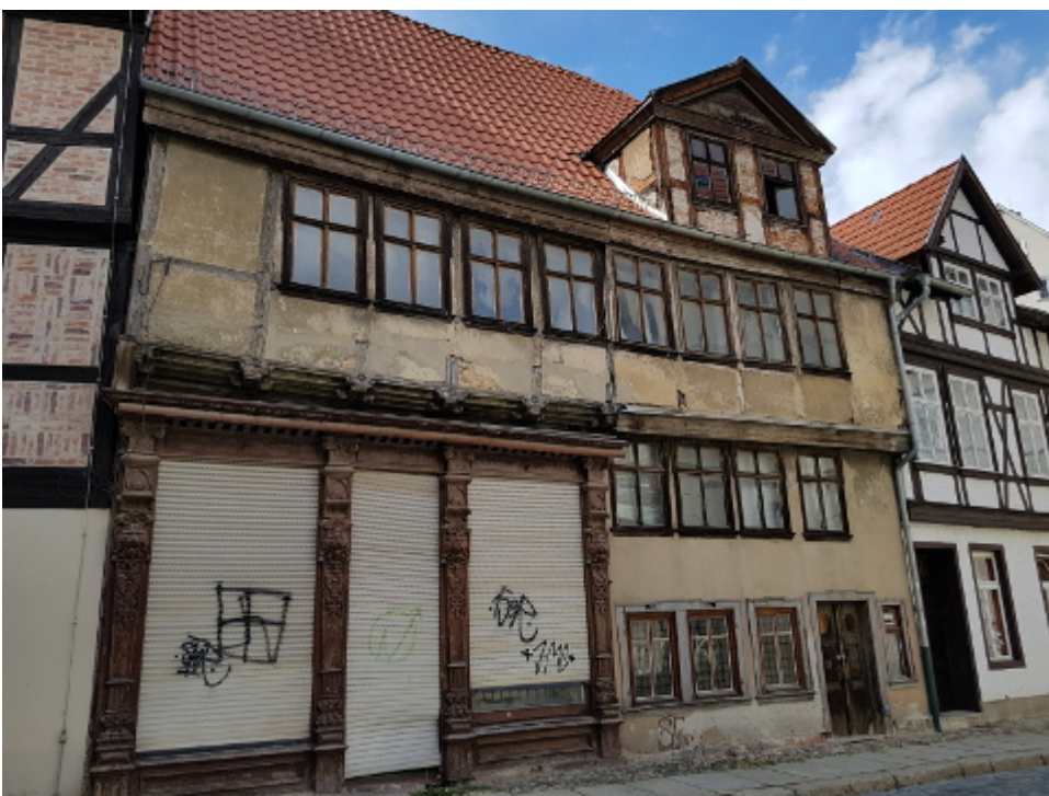
Unrenoviertes Haus in der Altstadt Quedlinburgs
